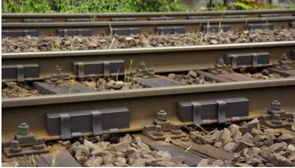
Abbildung 55: Schienenstegdämpfer im Verlauf der Elbtalstrecke.
